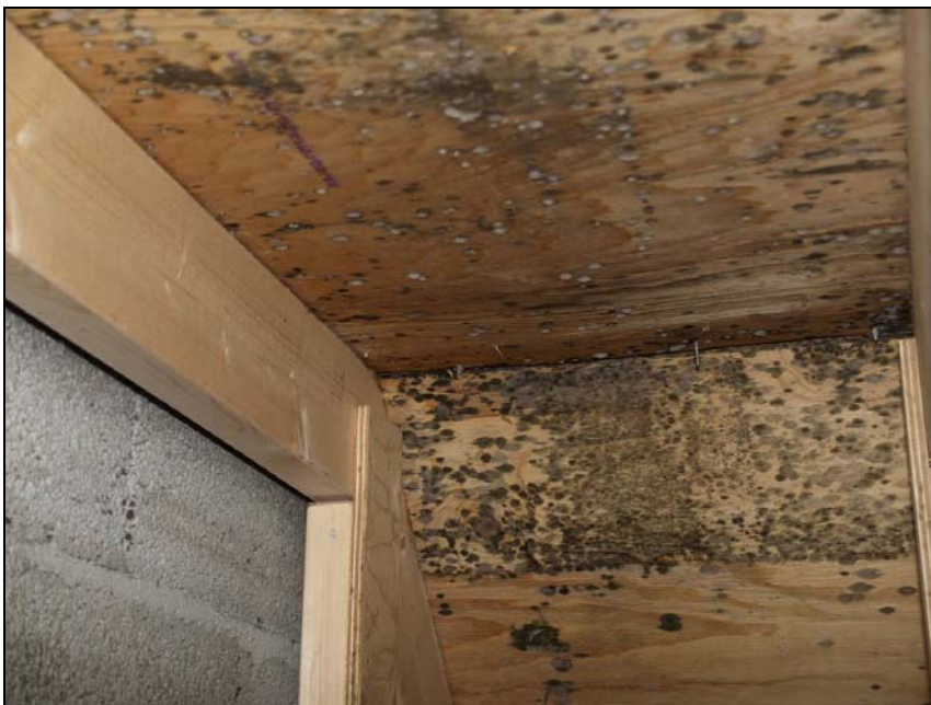
Bilde 2. Muggsoppvekst i undertak. Foto: Mycoteam
