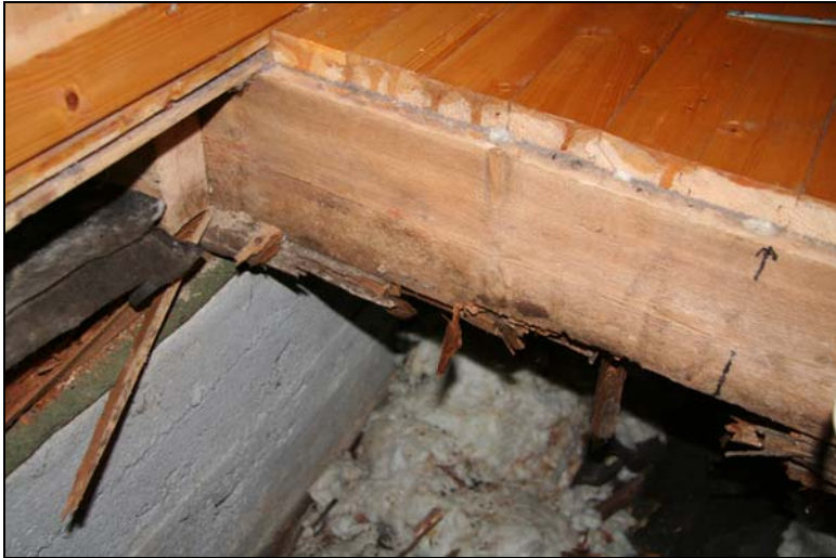
Bilde 1. Råteskader i kryperom. Foto: SINTEF Byggeforsk
