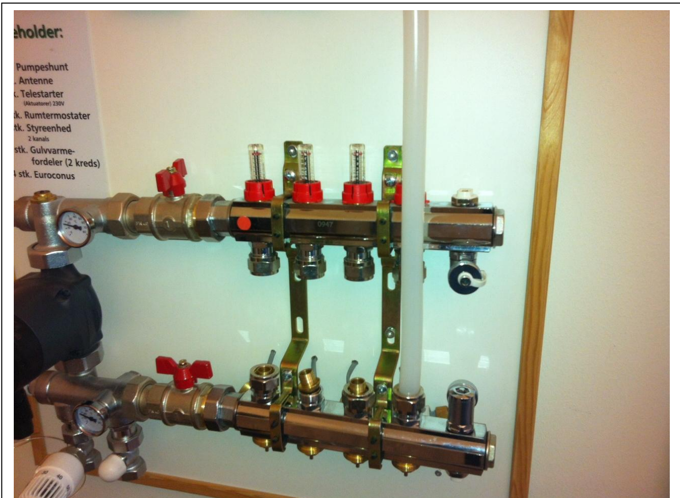
Fig. 5 Gulvvarmerøret fra retur-fordelerrøret går op foran flowmeter på fremløb-fordelerrøret.
