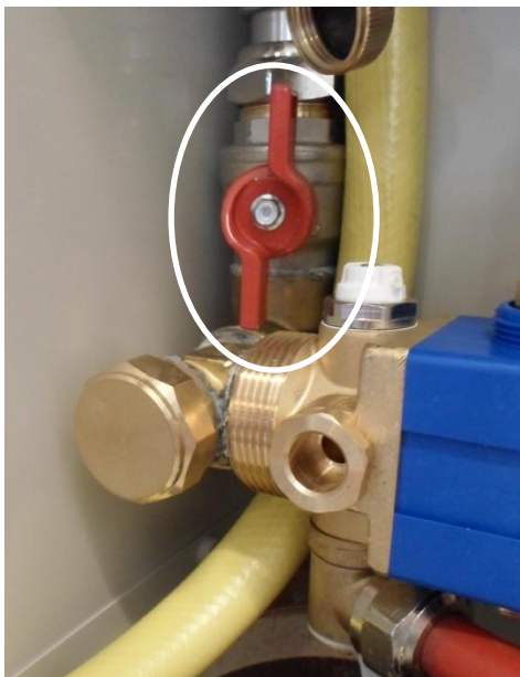
Ventil på returfordeler
