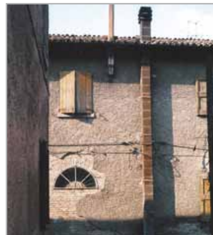
Fig. 5.3 - Vegg med stigende fuktighet
