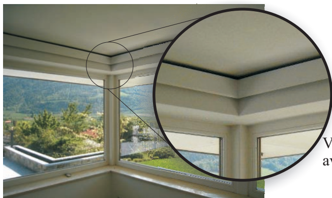
Kjølelist montert som taklist
