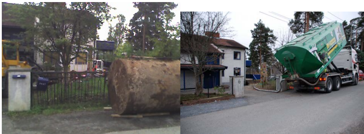
Gamle oljetanken fjernet – senere – bulkbilen fyller opp silo i kjeller med 6 tonn pellets. Bilder er tatt i 2008, Bærum.
