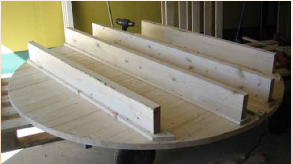
Fästbrädorna och reglarna ihopskruvade till T-balkar som skruvats fast i bottenbrädorna efter 20 mm-linjen.
