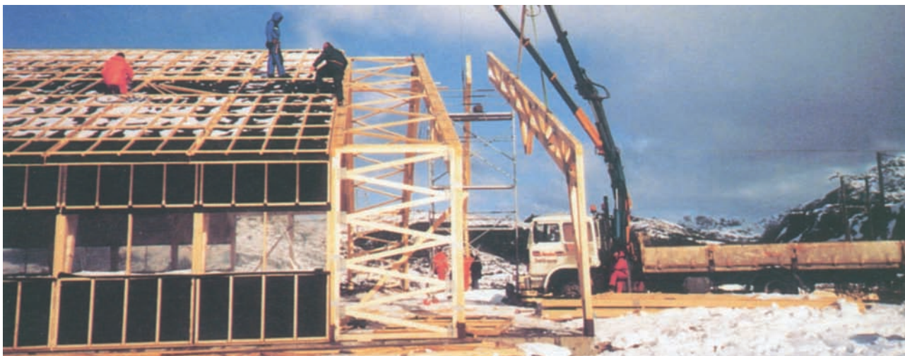
Figur 4.15 Avstivningsfagverk i industrihall. Monteres inn mellom rammer i enden av hallen (kilde: Vest Tre AS).
