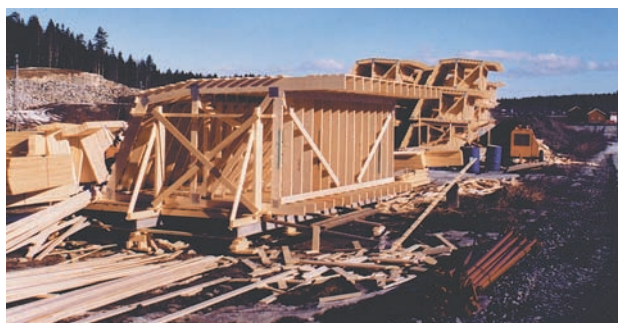
Figur 4.12 Forskaling til radartårn på Gardermoen. Alt ble montert sammen nede på bakken og heist opp på tårnet i bakgrunnen (kilde: Takstolfabrikken AS).
