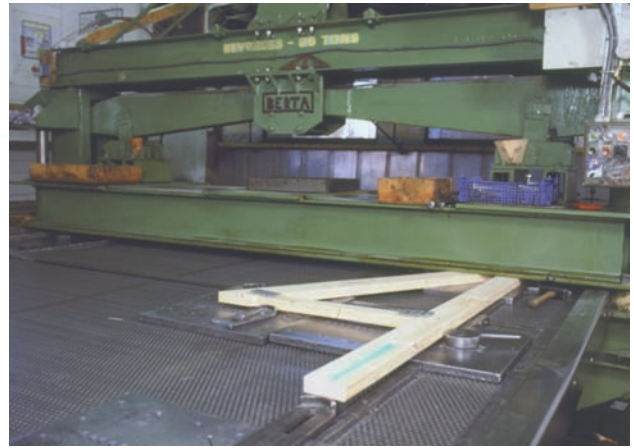
Figur 9.10 Pressebord med stasjonær traverspresse (kilde: Mjøstre AS).
