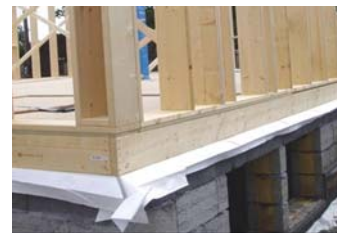
Figur 5.2 Eksempel på feil utførelse hvor man har bygget videre på en upusset lettklinkervegg.
