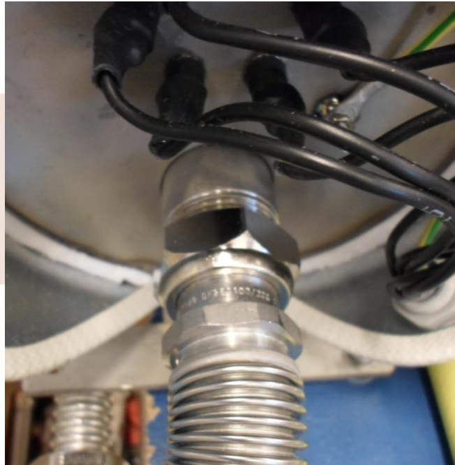
Bilde 2: Returløp, stenges med heldekkende pakningsmynt for at sentralen selv skal suge fra ekstern tank.
