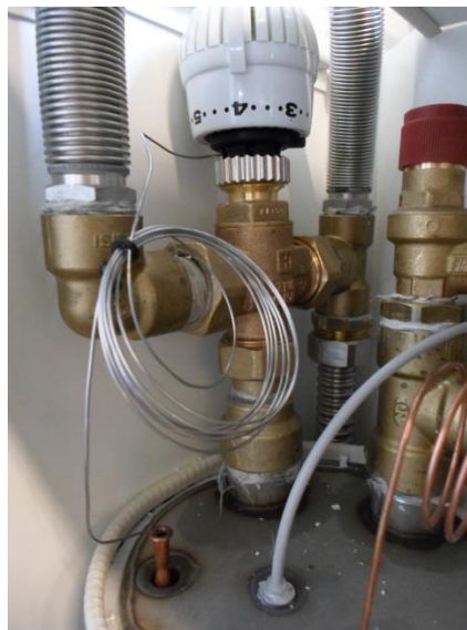
Bilde 4: 3-veis shunt. Returløp under elkolbe må være stengt, benyttes når det er høytemperert vann, og ikke ekstern matepumpe.
