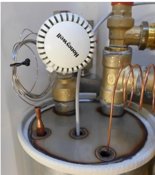
Bilde 3: 2-veis shunt innmontert. Krever at det er ekstern matepumpe.
