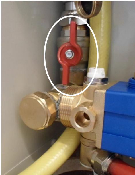
Ventil på returfordeler
