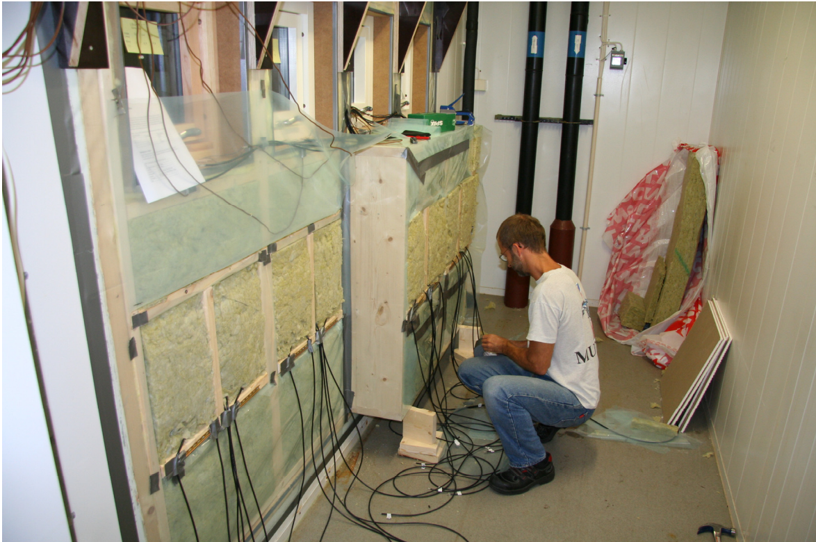
Figur 3.5 Oppbygging av veggfelt med tykkelse hhv 150 og 400 mm mellom to rom med styrt klima. Bildet er tatt fra "innsiden" (varmt klimarom).
