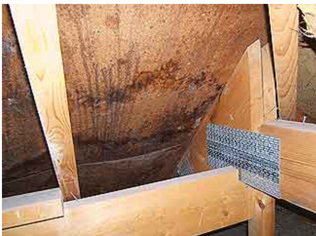
Figur 4.2 Det kan oppstå soppangrep på undertak som er fuktig over lange perioder. Det gjelder først og fremst dampette undertak som vist på bildet. Foto: SINTEF Byggforsk
