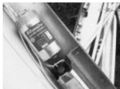
Lysrørarmatur med kondensator som inneholder PCB.
