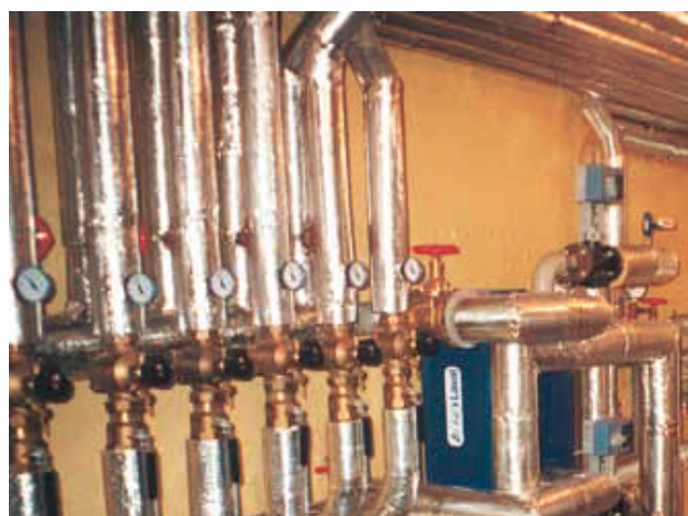
Sånn skal det se ut etter TEK10, riktig isolert med god avstand mellom rørene.
