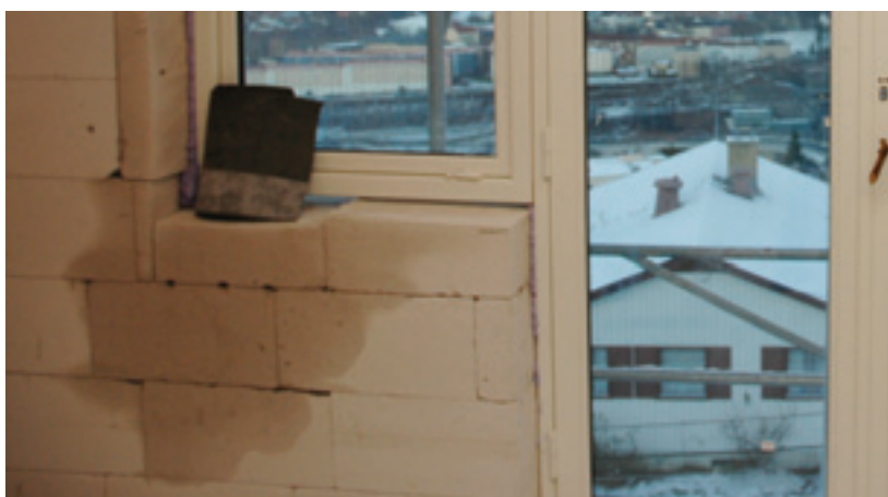
VENSTREHÅNDSARBEID: Vinduene i tilbygget er ikke i vater, og det er sprekker og gliper overalt. Etasjen under har fått store fuktskader, og hele huset må trolig totalrenoveres.
